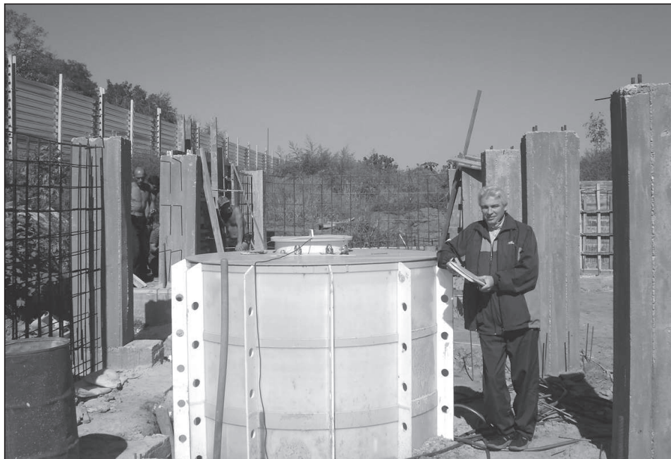
Рисунок 5. Промежуточный тепловой аккумулятор
